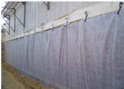
Пристенный дренаж и защита гидро- изоляции
